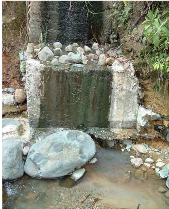
Foto 174 Vertido de aguas residuales hacia la quebrada La Limona, provenientes de la urbanización Prados del Campo, recién construida. Esta estructura parece haber sido construida para aguas lluvias, pero está siendo utilizada para vertido de aguas servidas. La situación se repite en por lo menos 20 sitios más de esta y otra quebradas por parte de las nuevas urbanizaciones.
