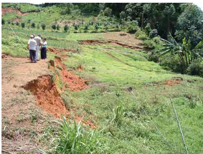
Foto 2 Deslizamiento en primeras fases en Potrerito, quebrada La Barro Azul
